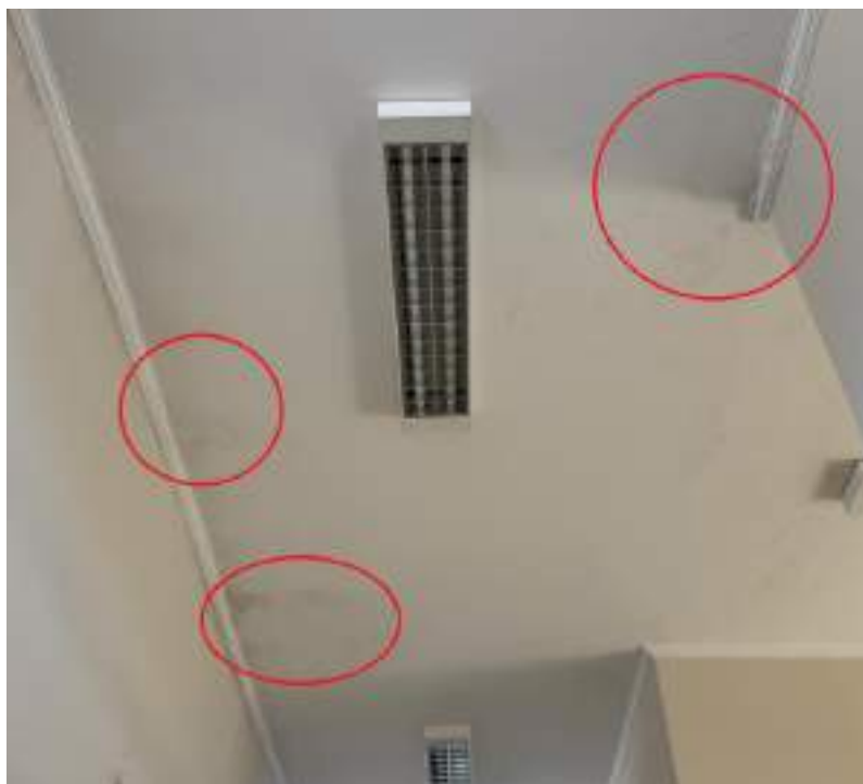
Figura 31 - Manchas na pintura da laje, abaixo da região com módulos fotovoltaicos - Bloco CADM1
