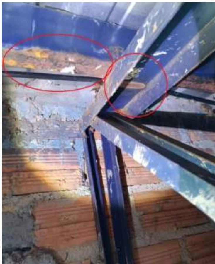
Figura 13 - Elementos com início do processo de corrosão superficial
