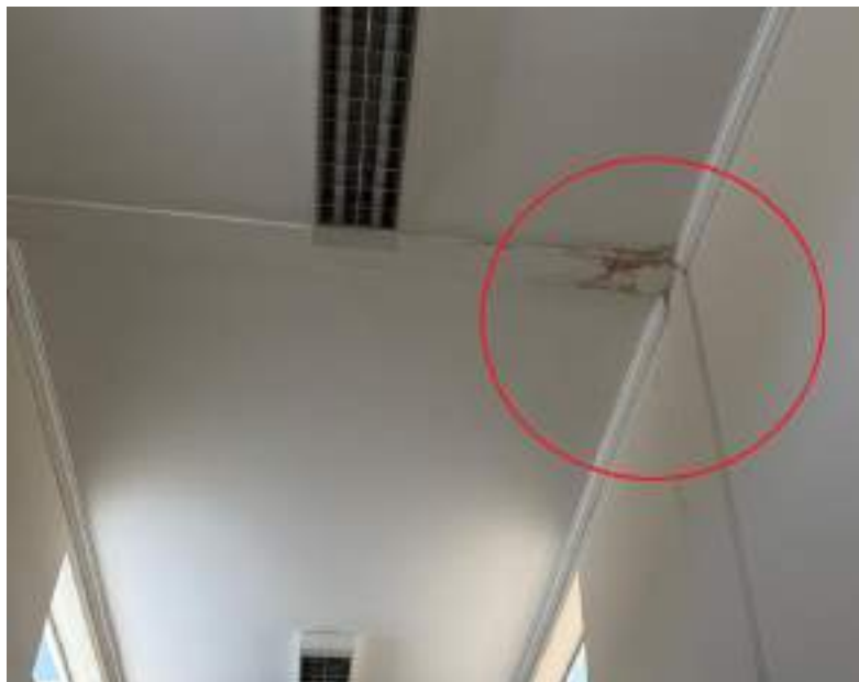
Figura 30 - Manchas próximo a junta de dilatação do bloco do CADM1
