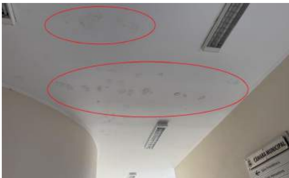
Figura 37 - Manchas na laje da cobertura do bloco PL4
