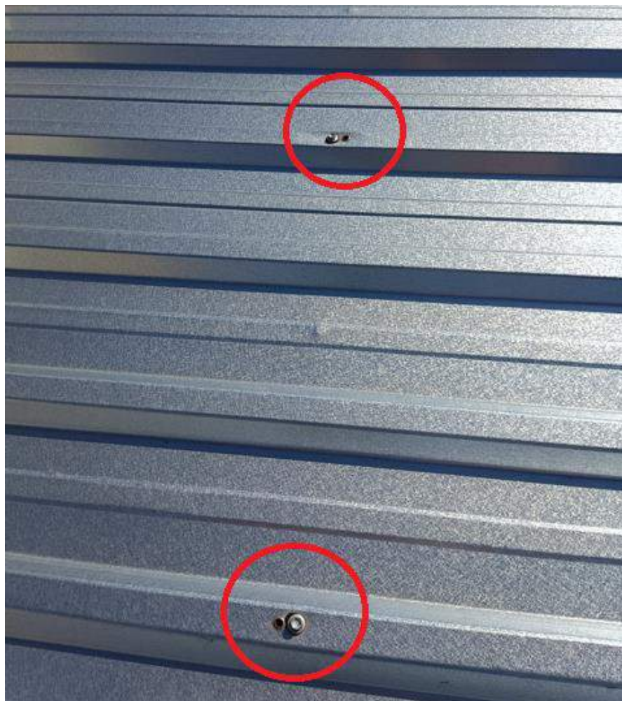
Figura 27 - Furos sem vedação na cobertura do bloco ADM2
