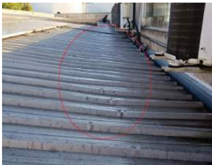
Figura 4 - Imagem das telhas amassadas no bloco GB1
