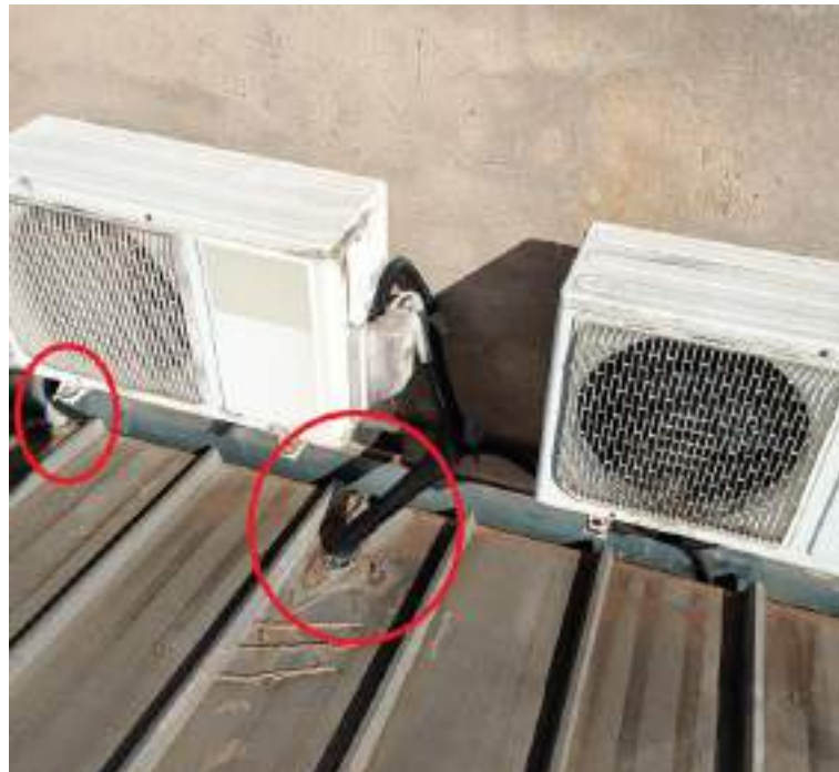
Figura 15 - Furos nas telhas do bloco GB1
