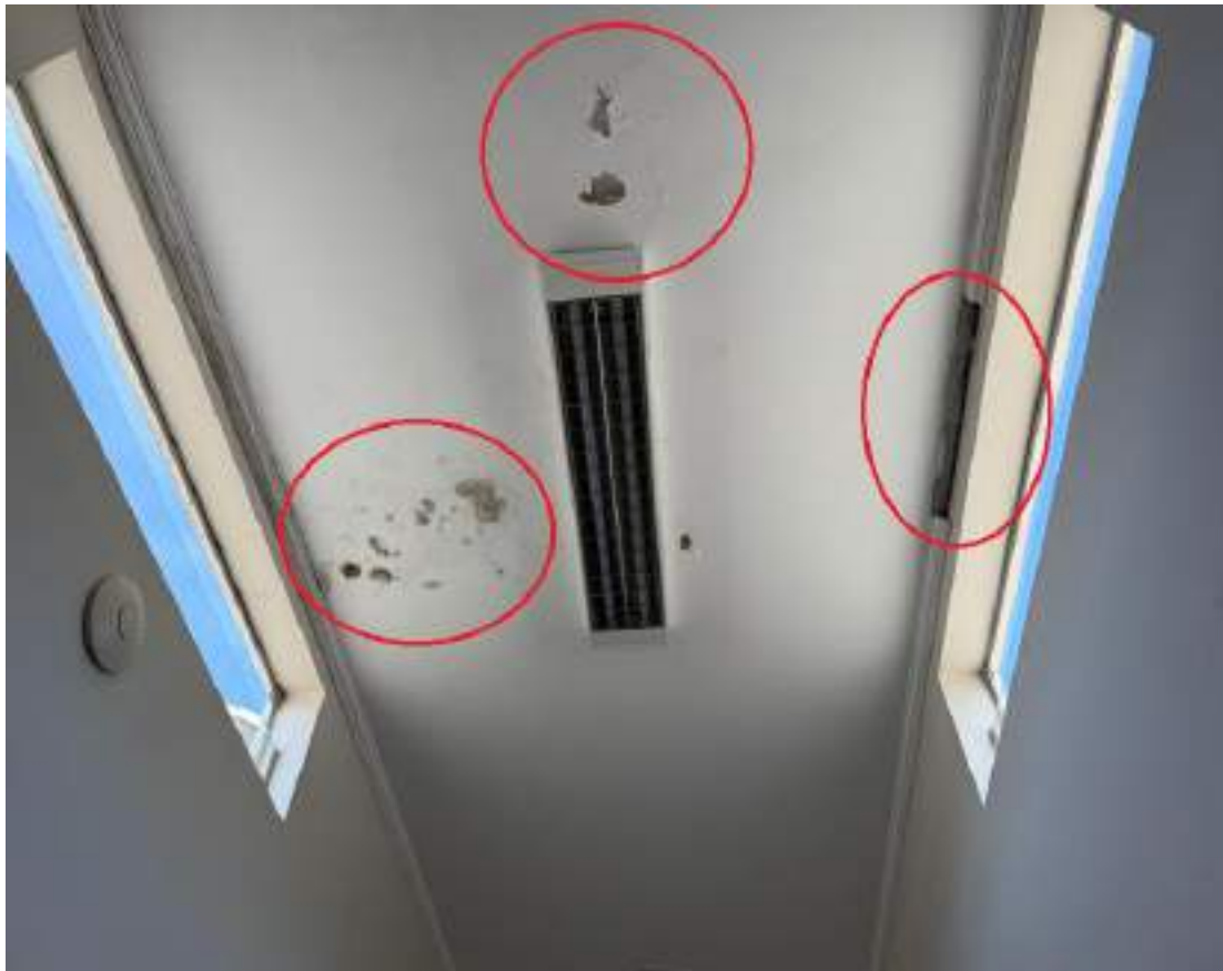
Figura 20 - Manchas e deslocamento na laje do corredor do CGB1
