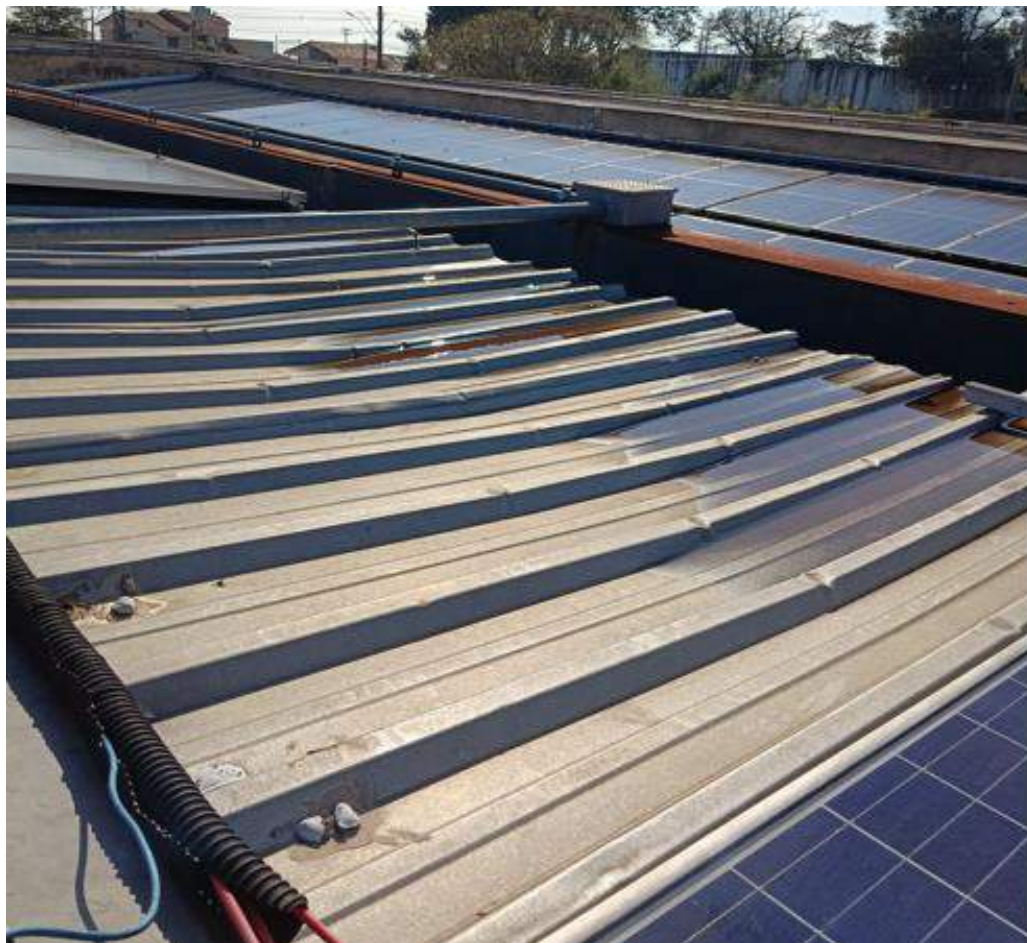
Figura 19 - Telhas amassadas sobre o corredor dos gabinetes - bloco CGB1
