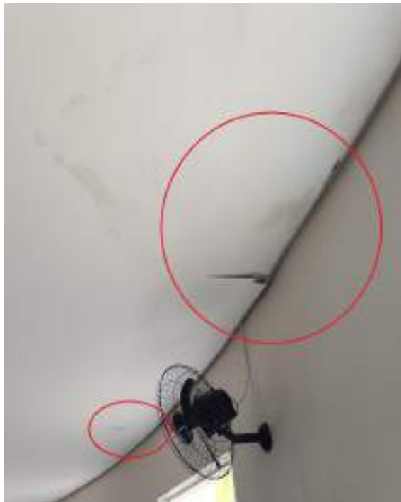
Figura 43 - Mancha e deslocamento do forro de gesso no bloco PL2
