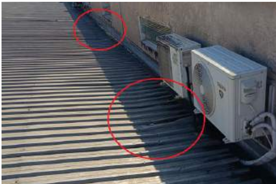
Figura 23 - Telhas amassadas próximo a calha e alvenaria - Bloco ADM1
