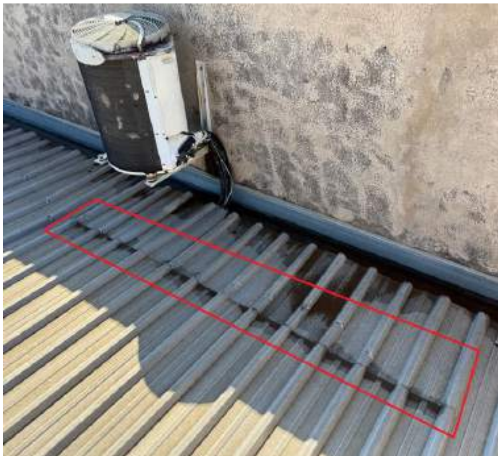
Figura 22 - Telhas amassadas próximo as calhas e alvenaria - Bloco CZ1
