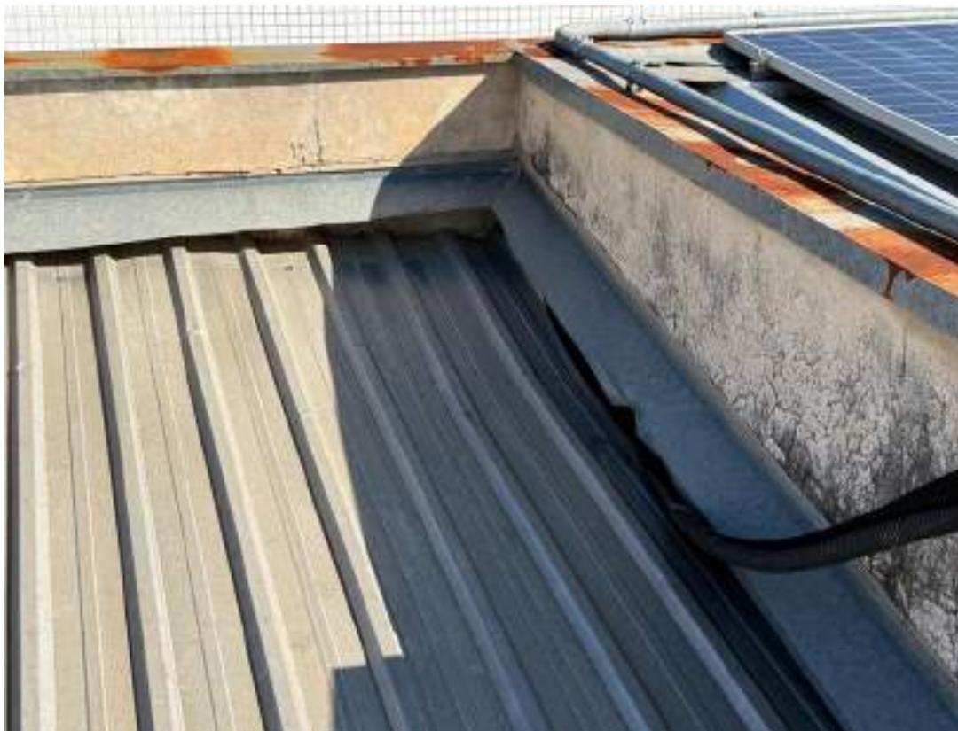
Figura 21 - Desprendimento da telha em relação ao rufo - Bloco CZ1
