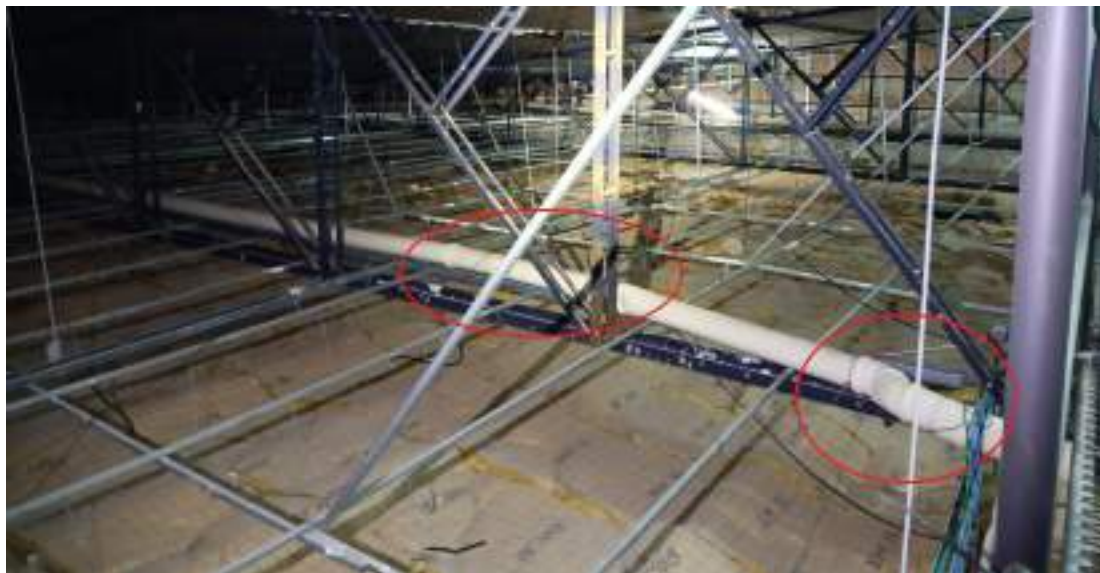
Figura 48 - Tubulação pluvial incorreta no bloco PL1
