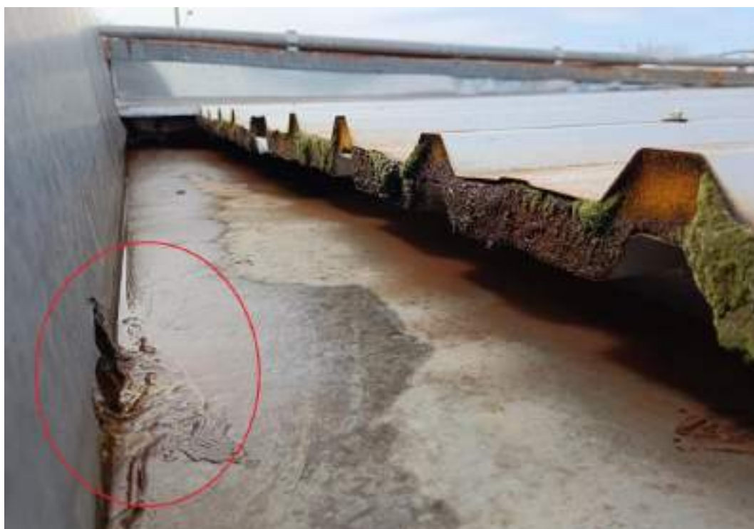
Figura 32 - Condutor lateral para as calhas do bloco CADM2
