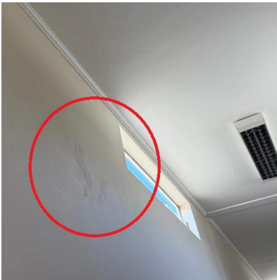
Figura 18 - Manchas na alvenaria do corredor dos Gabinetes, adjacente às calhas do bloco GB2
