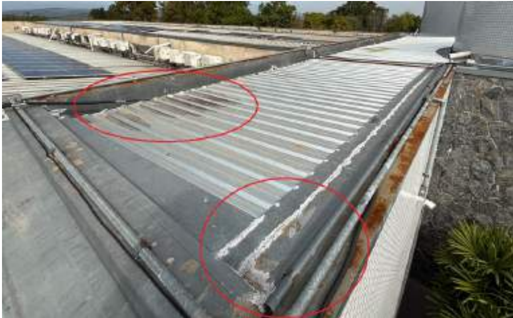
Figura 33 - Acúmulo de água no telhado do bloco CADM2
