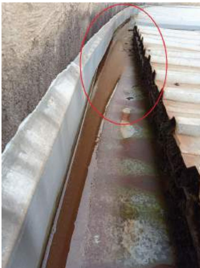
Figura 41 - Acúmulo de água na calha do bloco PL2
