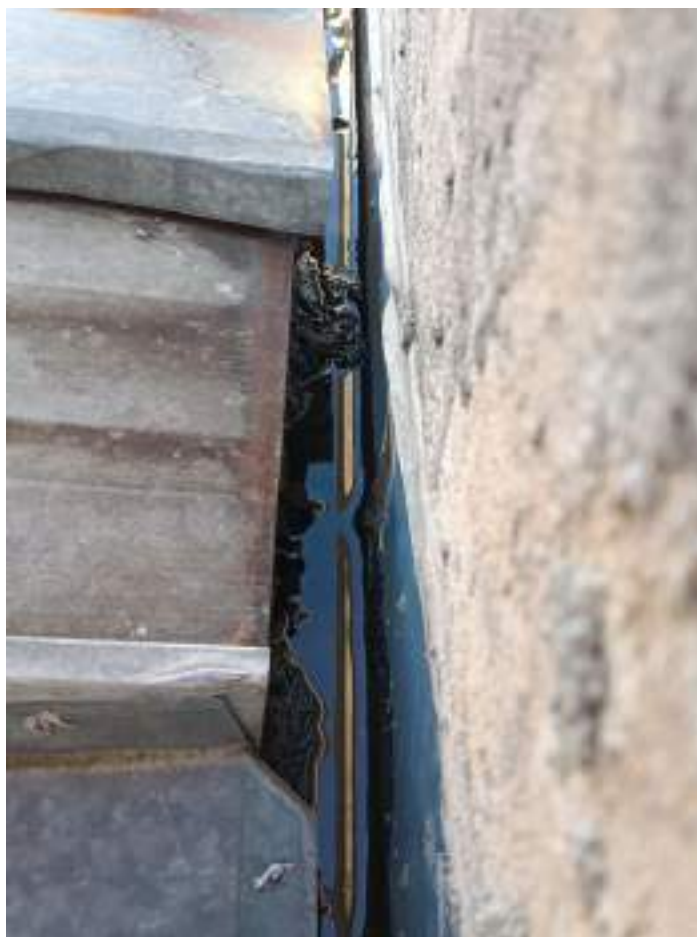
Figura 17 - Telha muito próxima a alvenaria - bloco GB2
