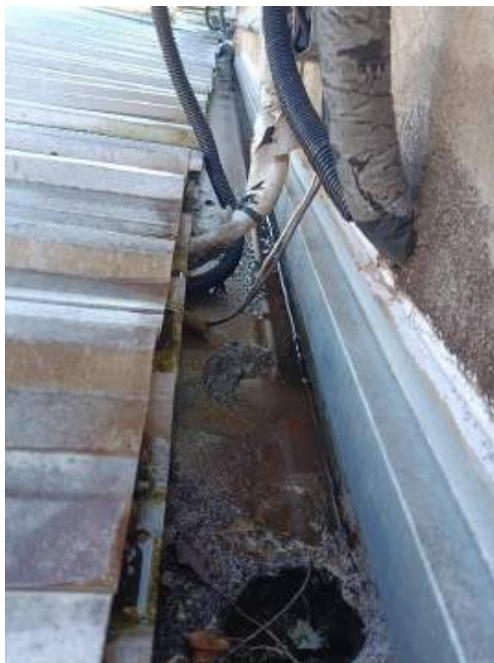
Figura 7 - Calha com empoçamento – Bloco GB1
