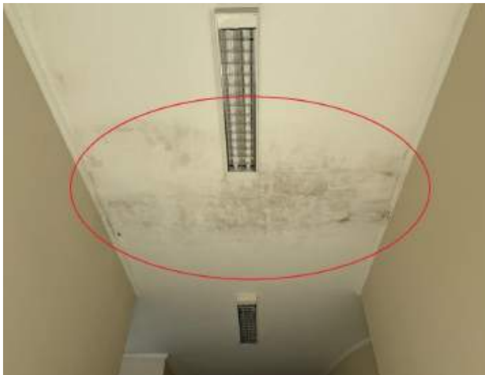
Figura 36 - Manchas na laje da cobertura do bloco PL4
