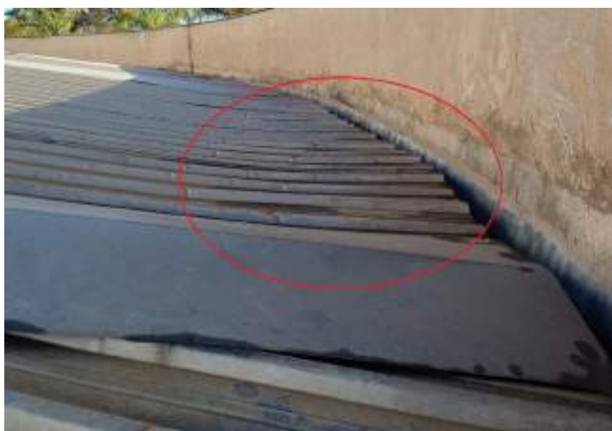
Figura 40 - Telhas amassadas próximo a calha no bloco PL2
