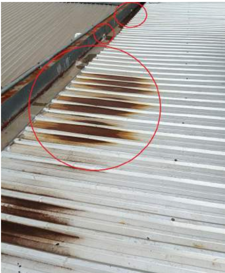
Figura 35 - Acúmulo de água no telhado do bloco PL4
