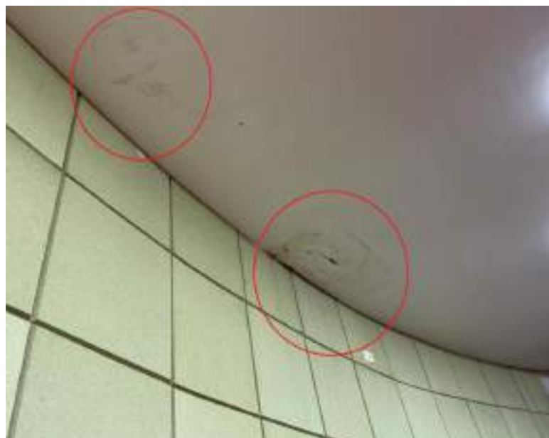
Figura 47 - Mancha nos forros próximos as calhas no bloco PL1
