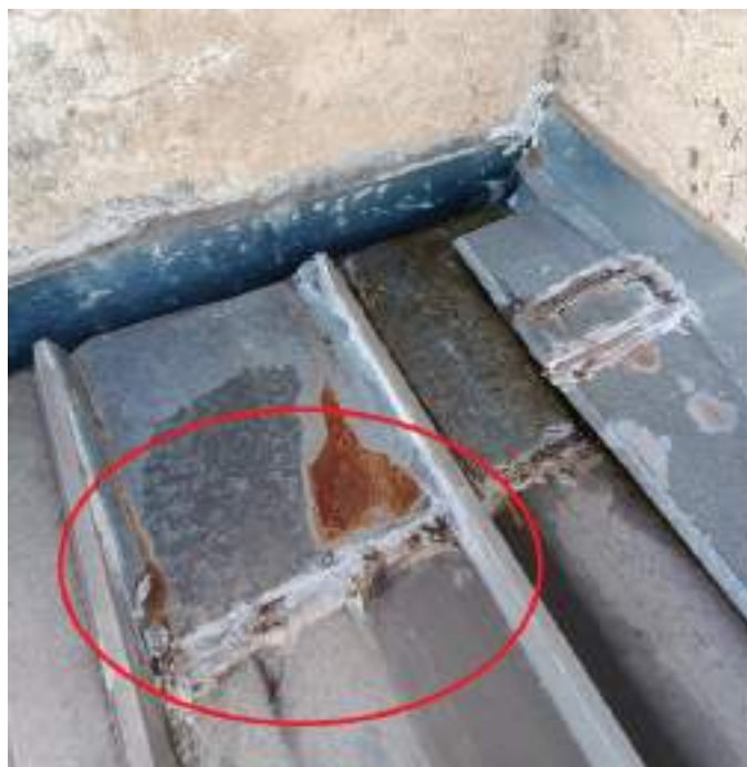
Figura 16 - Emenda em telha no bloco GB2
