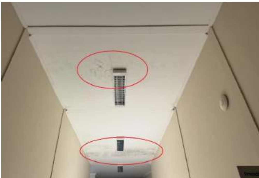
Figura 34 - Manchas na laje da cobertura do bloco CADM2
