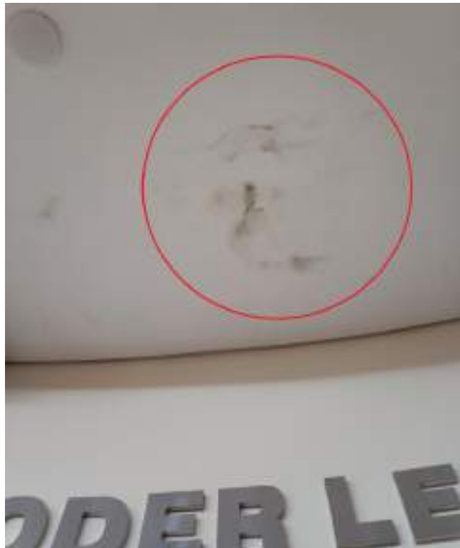
Figura 46 - Mancha no forro de gesso do PL1 devido a infiltração
