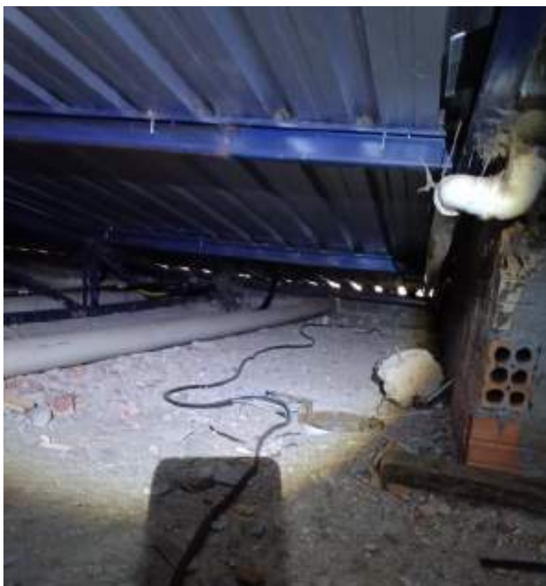
Figura 9 - Condutor horizontal sobre laje sem inclinação
