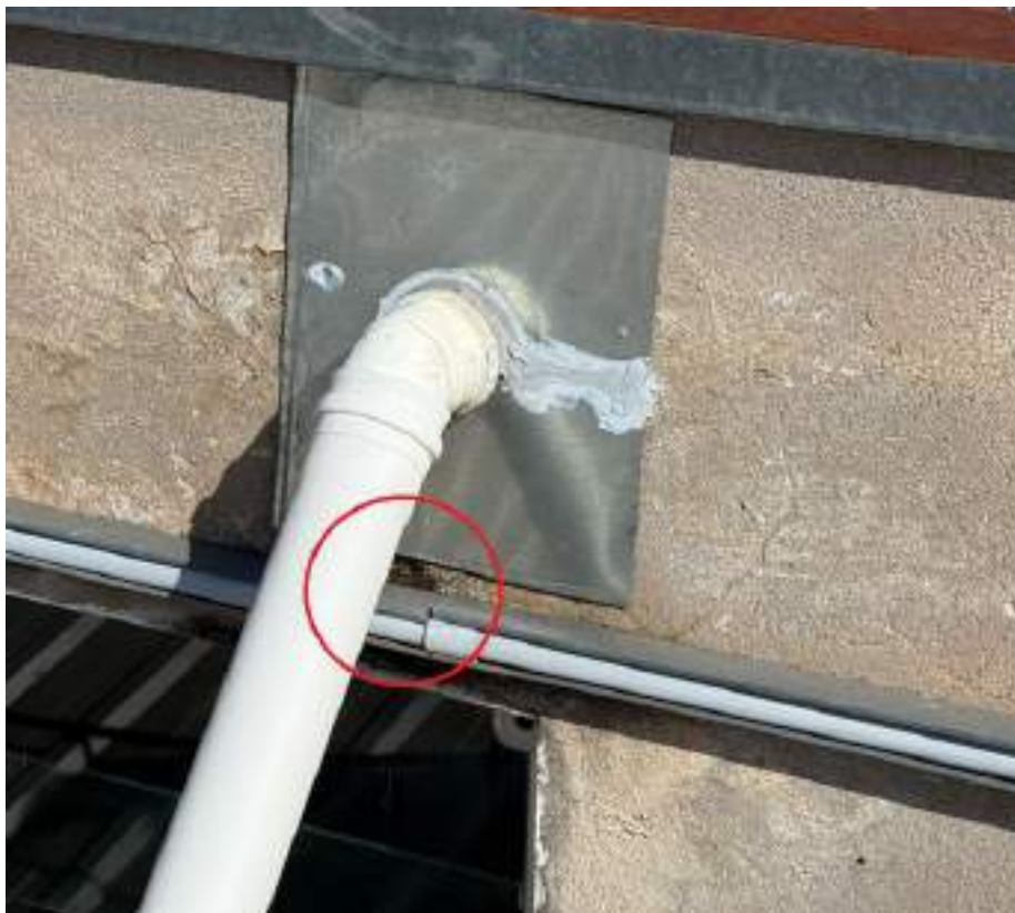
Figura 28 - Mofo próximo ao furo do condutor do telhado adjacente
