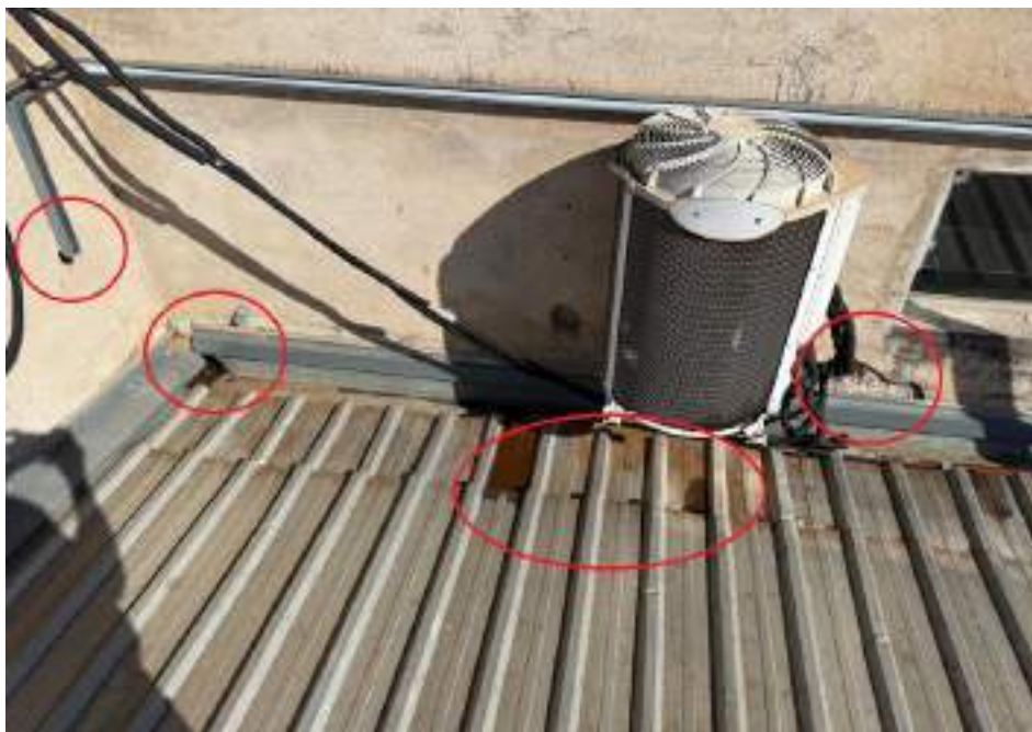
Figura 25 - Região com emenda de telha por traspasse - Bloco ADM2
