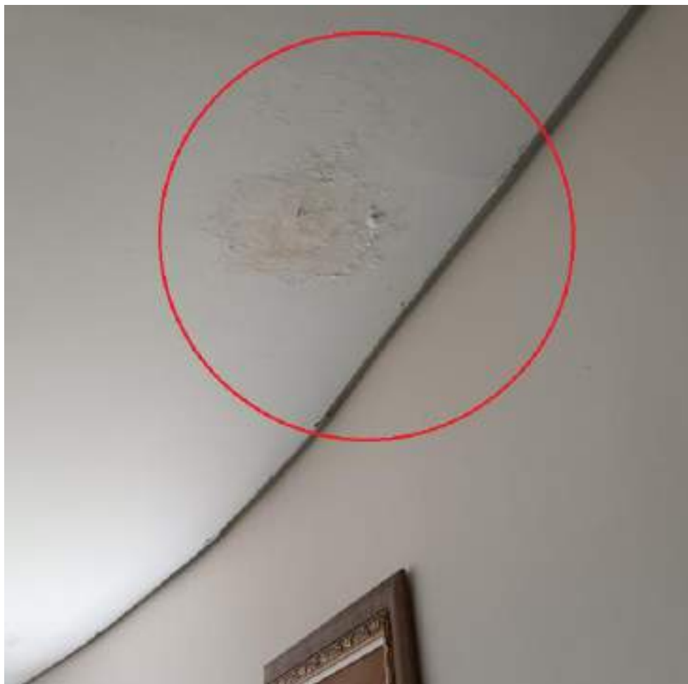
Figura 42 - Mancha no forro de gesso devido a infiltração - Bloco PL2
